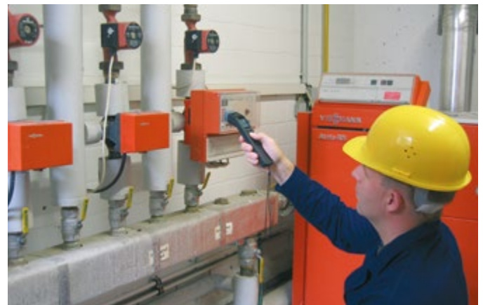
Überprüfen der Temperatur an Heizkreisen
